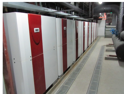
Wärmepumpen im Technikraum
