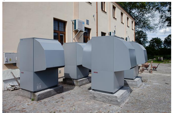
Budynek 2- 4 zewnętrzne pompy ciepła powietrze-woda LA28AS
