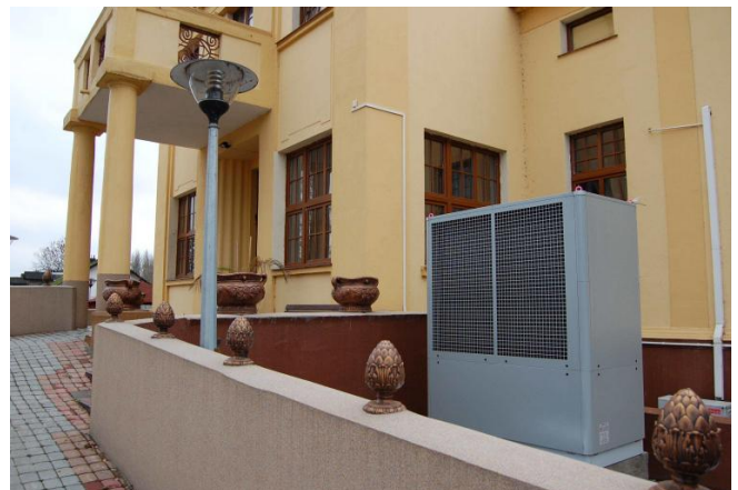
Budynek 1 - Zewnętrzna pompa ciepła powietrze-woda LA60TU
