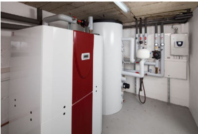
Wärmepumpe mit Wärmepumpen-Manager rechts hinten
