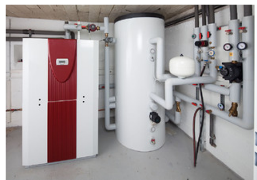
Dimplex Sole/Wasser-Wärmepumpe im Technikraum
