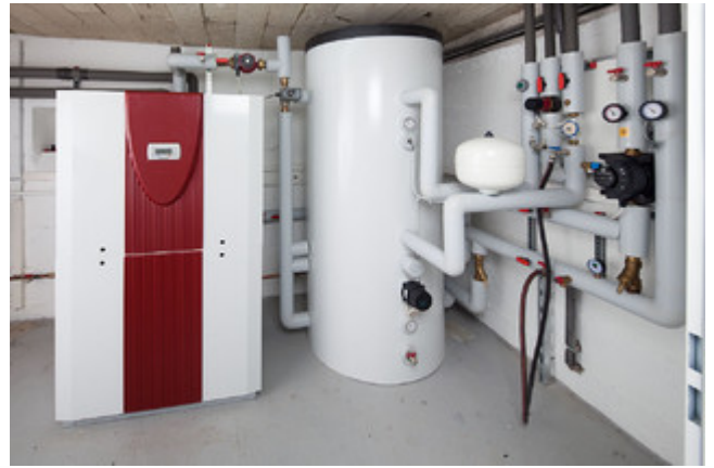
Dimplex Sole/Wasser-Wärmepumpe im Technikraum
