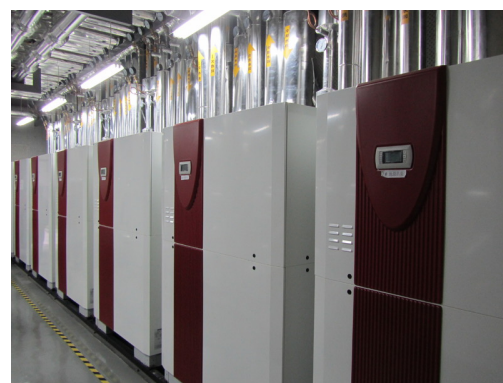
Dimplex Wärmepumpen im Technikraum 2
