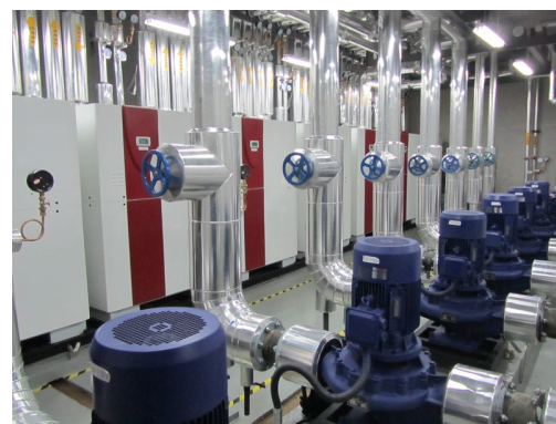
Dimplex Wärmepumpen im Technikraum
