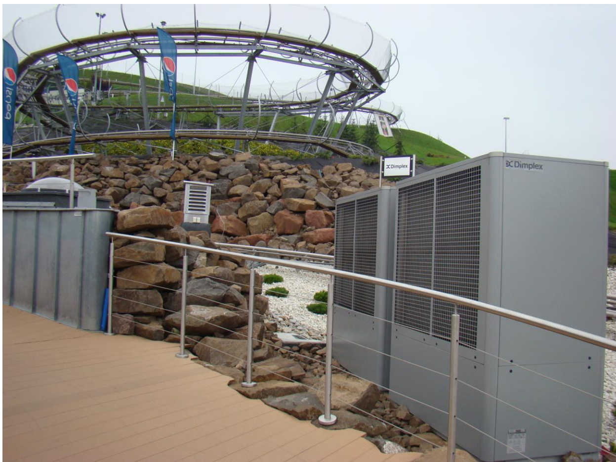
Fot.2: 2 pompy powietrze-woda LA60TU marki Dimplex o łącznej mocy 90kW ogrzewające obiekty gastronomiczne na Malta Ski w Poznaniu
